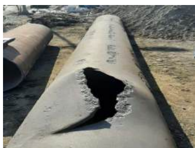
شکل ۲- پارگی خط لوله
