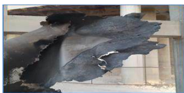
نمایی از پارگی خط لوله
