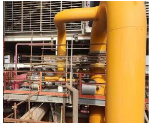
شیر کنترل فشار بالای ظرف رفلاکس
