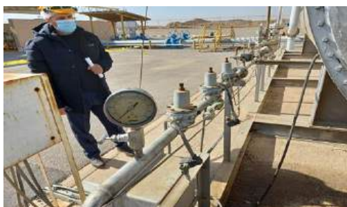
سیستم کنترل هیتر حادثه دیده
