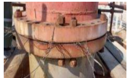
تخریب گسکت فلنج
