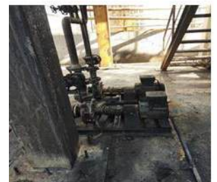
آثار سوختگی تاسیسات ناشی از آتش سوزی
