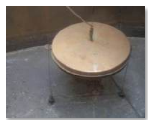
شناور مکانیکی موجود
