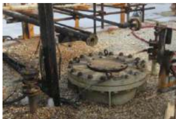
شکل ۴- فلنج محل نصب پمپ عمودی
