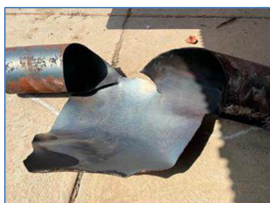
شکل ۲- پارگی خط لوله
